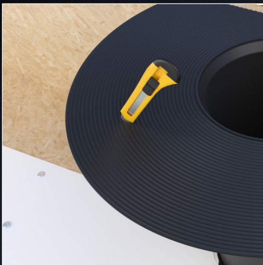
Podcięcie gilzy od zewnętrznej strony parapetu.
